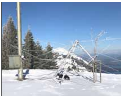
Erster Sturmschaden (Feb. 2020)
