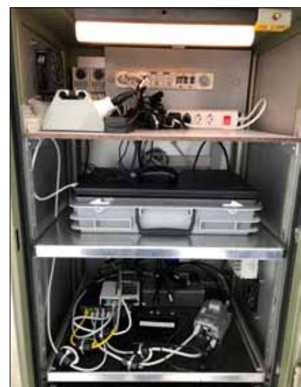
Alter Geräteschrank am Mast mit SDR-RX
